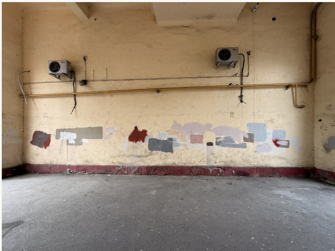
ТАДЖИКСКИЙ РОТКО Слои краски и следы ремонта
